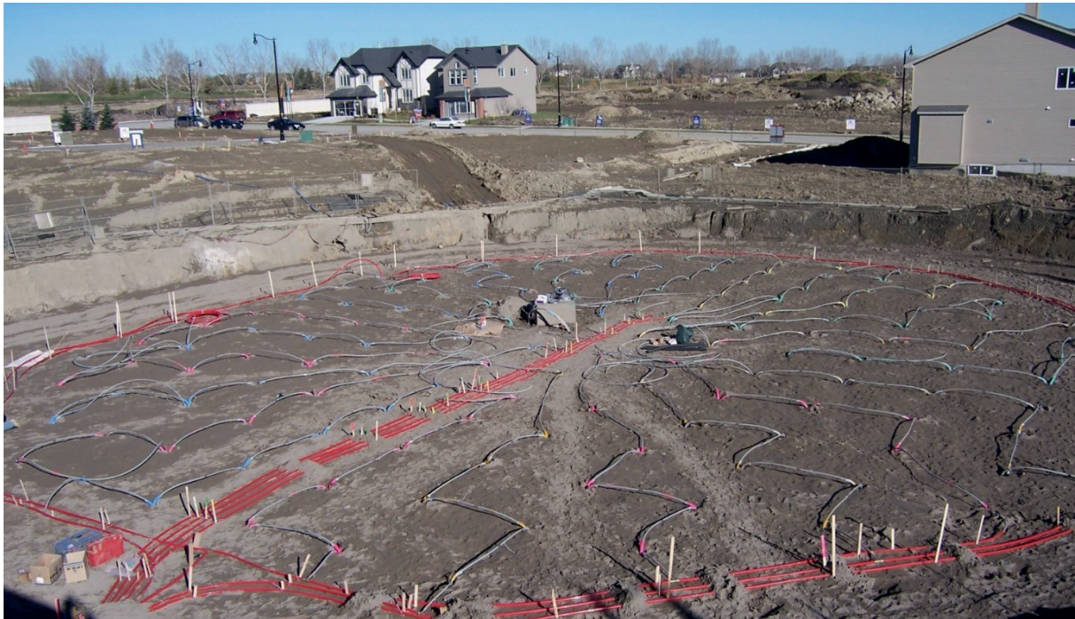
Abbildung 10: Verrohrung des Erdsondenspeichers der Drake Landing Solar Community in Kanada (mit freundlicher Genehmigung von NRCan).
